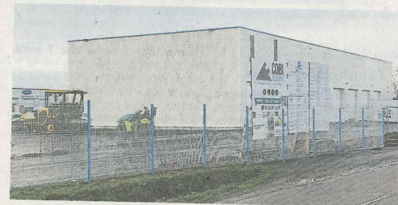
Le nouveau bâtiment de l'entreprise Lecapitaine accueille la plateforme logistique et l'atelier de réparation.
